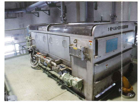
■機械濃縮機(ベルト型ろ過濃縮機)
